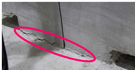
図-13 実験で確認された柱高さ 0mm における水平ひび割れ
