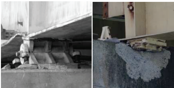
(i) アンカーの抜け出し (ii) 可動支承ローラーの逸脱
