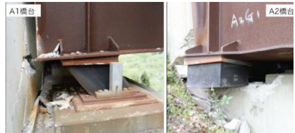
写真-10 俵山大橋のゴム支承の逸脱
