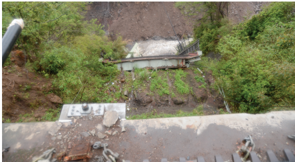
写真-13 流出した阿蘇大橋の桁部
