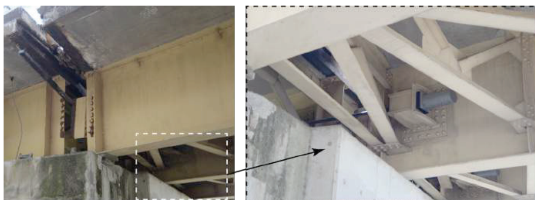
写真-21 桁連結版・支承破壊による隣接桁間の開きと桁間連結ケーブル(P20) (4月16日撮影)
