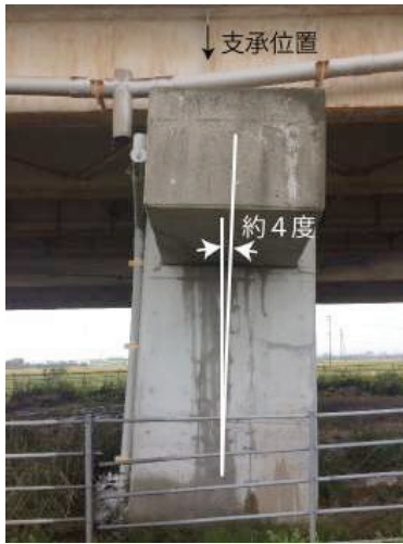
写真-22 RC柱の傾斜 (5月9日撮影)
