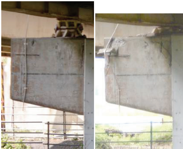
(i) 前震後 (4/15 撮影) (ii) 本震後 (4/16 撮影)
