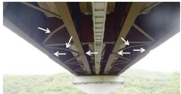
写真-11 俵山大橋の桁部の座屈損傷
