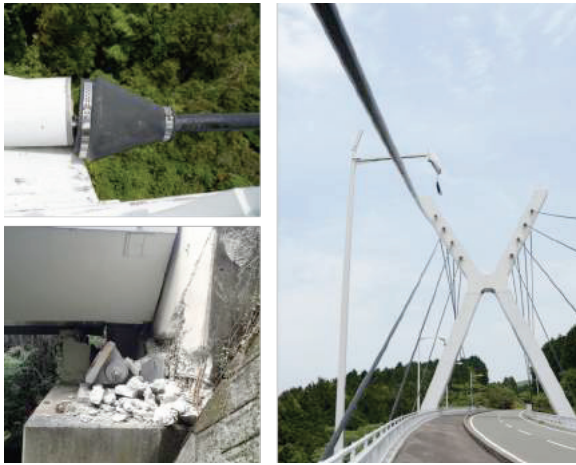
写真-8 桑鶴大橋の損傷状況
