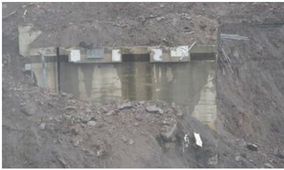
写真-12 流出した阿蘇大橋の橋台部
