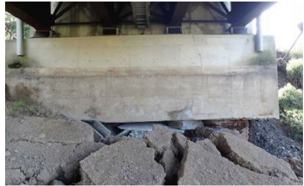
写真-9 俵山大橋の橋台周辺地盤の変状
