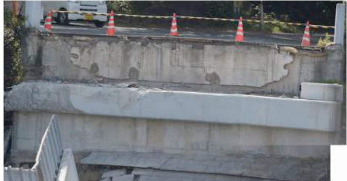
写真-2 府領第一橋東端橋台部の損傷状況
