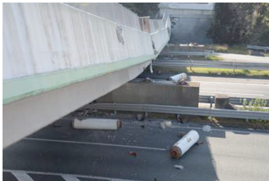
写真-1 落橋した府領第一橋
