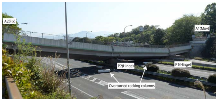
図-7 府領第一橋の本震による落橋(2016年4月16日撮影)
