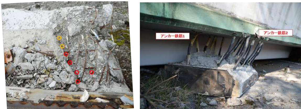
図-20 横変位拘束構造の取付部上面と落下して天地逆になった横変位拘束構造 (図中の赤・橙の○はアンカー鉄筋2の痕跡)
