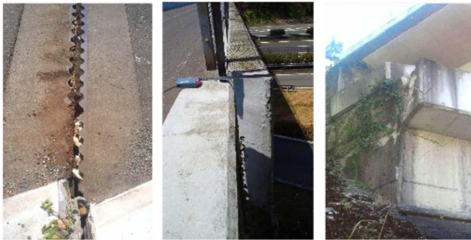
図-6 府領第一橋の前震後の桁の橋軸直角方向変位（西日本高速道路株式会社提供）
