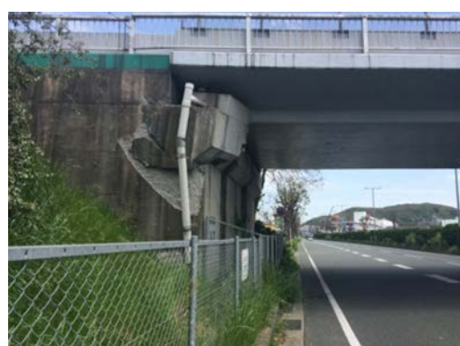
(ii) 横変位拘束構造の破壊
