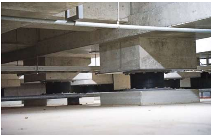
地階に備え付けられた免震構造
