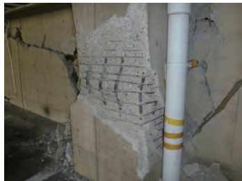
図3 共同住宅D（熊本市東区、1992年建設） 熊本地震におけるピロティ柱のせん断破壊 3
