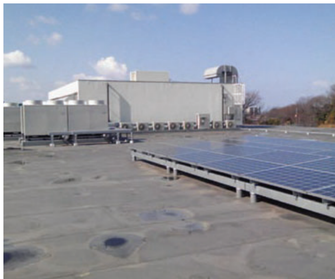
図2 全面改装された屋上。手前に太陽光パネル、奥に大型除湿器用室外機と二階機械室が見えている。
