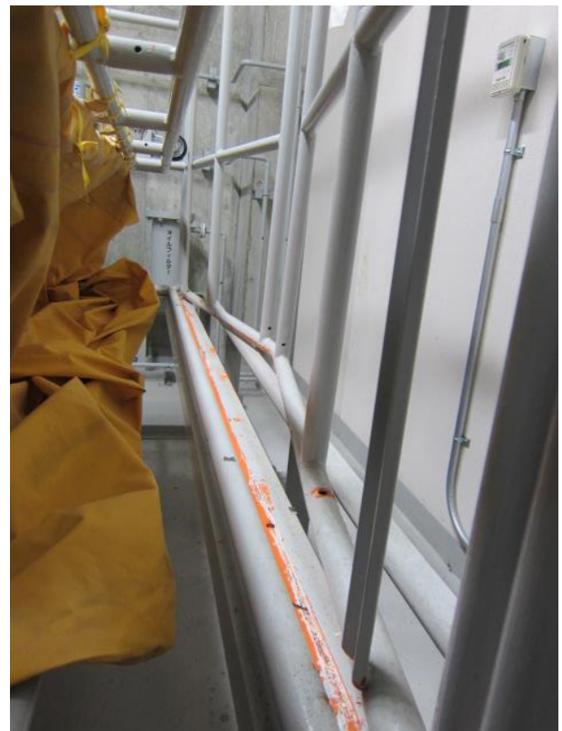
図3 鉄柵湾曲のため、柵ごと固定ネジが破断
