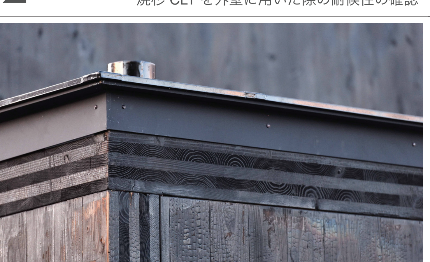
焼き杉CLTによる建物詳細部 箱ユニット一層根板金接合部 / 総建工業CLT工場第2加工工場の休務所兼事務所 (2021-2022) 林野庁 CLTを活用した建築物等実証事業2022 採択事業 焼杉 CLT を外壁に用いた際の耐候性の確認
