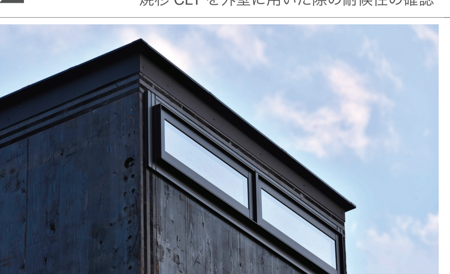
焼き杉CLTによる建物詳細部 箱ユニット一サッシ接合部 / 総建工業CLT工場第2加工工場の休務所兼事務所 (2021-2022) 林野庁 CLTを活用した建築物等実証事業2022 採択事業 焼杉 CLT を外壁に用いた際の耐候性の確認
