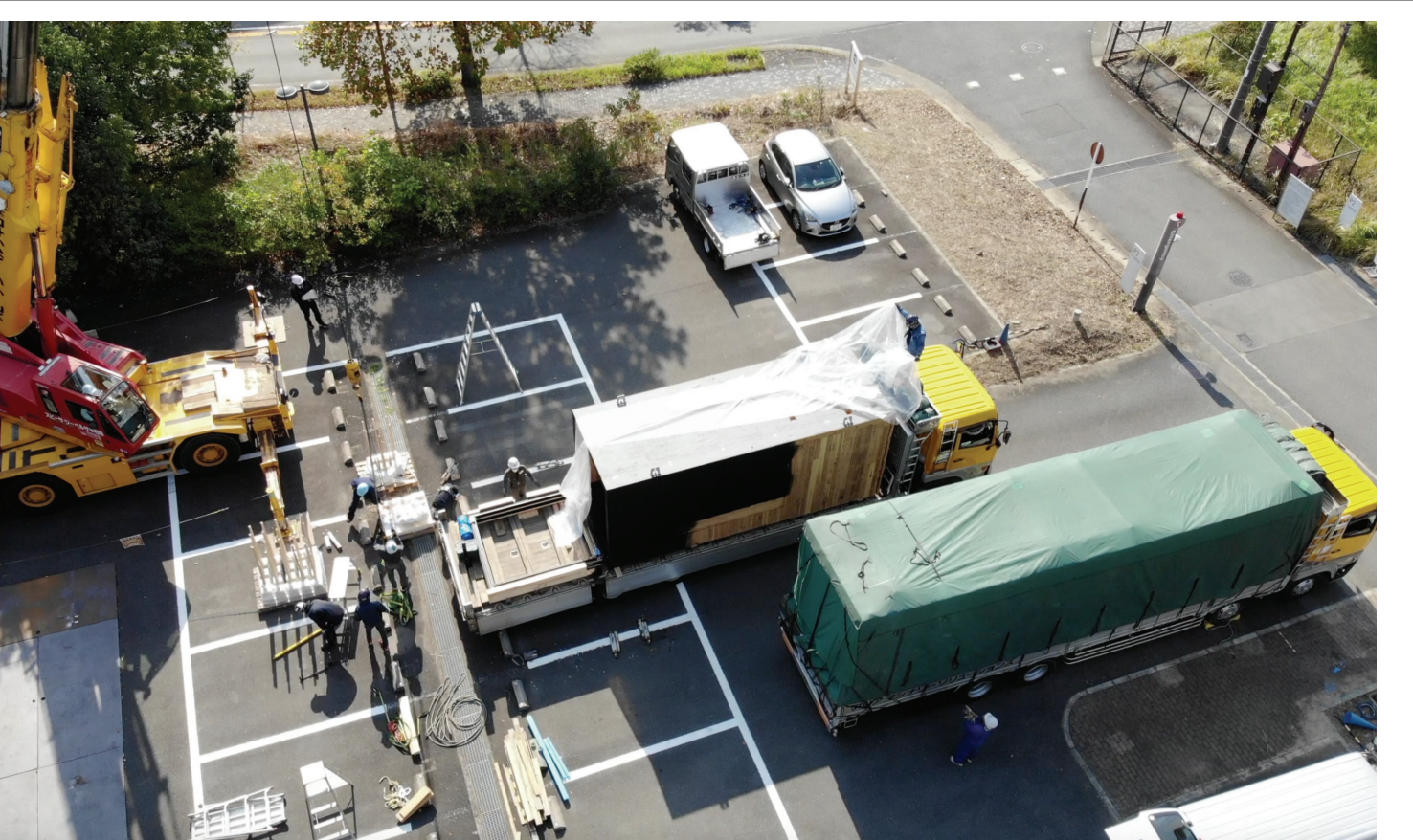
製作したCLTモジュールの外寸は運搬時のトラックの最大可搬寸法から / 総建工業CLT工場第2加工工場の休務所兼事務所 (2021-2022) 林野庁 CLTを活用した建築物等実証事業2022 採択事業 ユニット工法にかかる設計、施工の合理化
