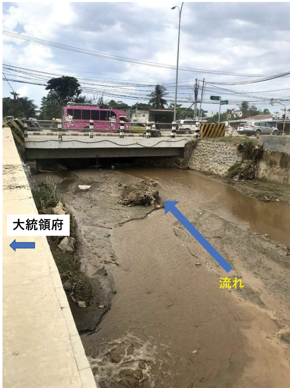
写真1 氾濫域AのA-point (4月8日撮影)
