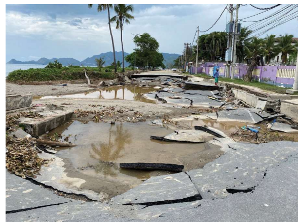
写真5 日本大使館前の道路陥没 (4月8日撮影)
