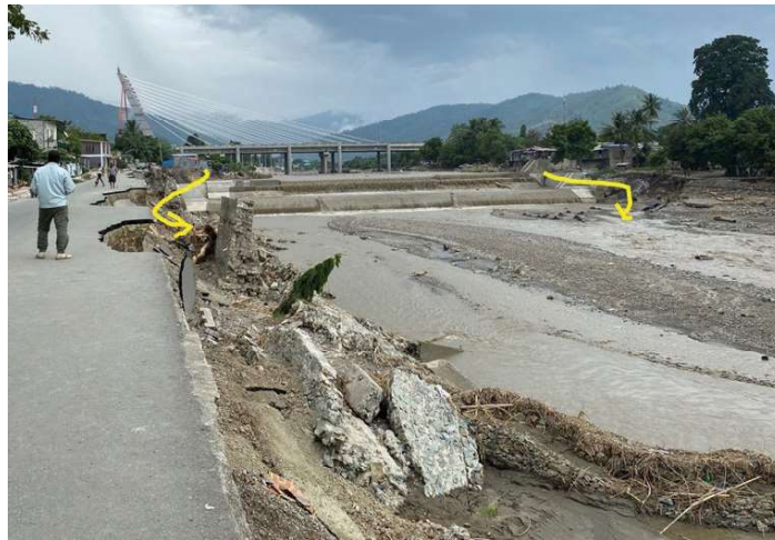
写真9 A-pointの被災状況（Comoro川）（4月8日撮影）
