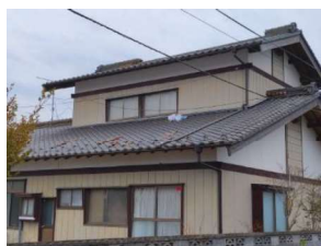
写真 35 瓦屋根の被害
