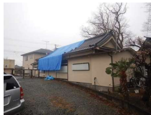
写真 55 瓦屋根の被害
