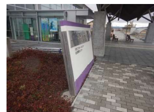
写真12 掲示板の 被害
