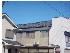
写真 51 瓦屋根の被害
