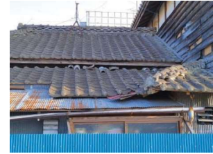
写真4 屋根瓦の被害
