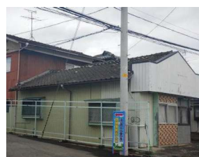
写真 43 瓦屋根の被害
