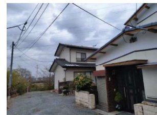
写真 60 瓦屋根の被害
