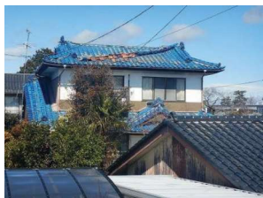
写真 47 瓦屋根の被害
