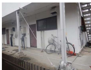
写真 39 ブレースと 柱根巻の被害
