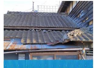
写真4 屋根瓦の被害
