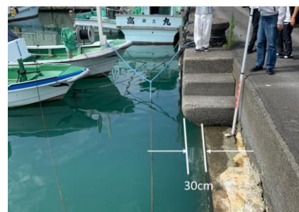
写真-6 佐喜浜漁港の岸壁上部ブロックの突き出し
