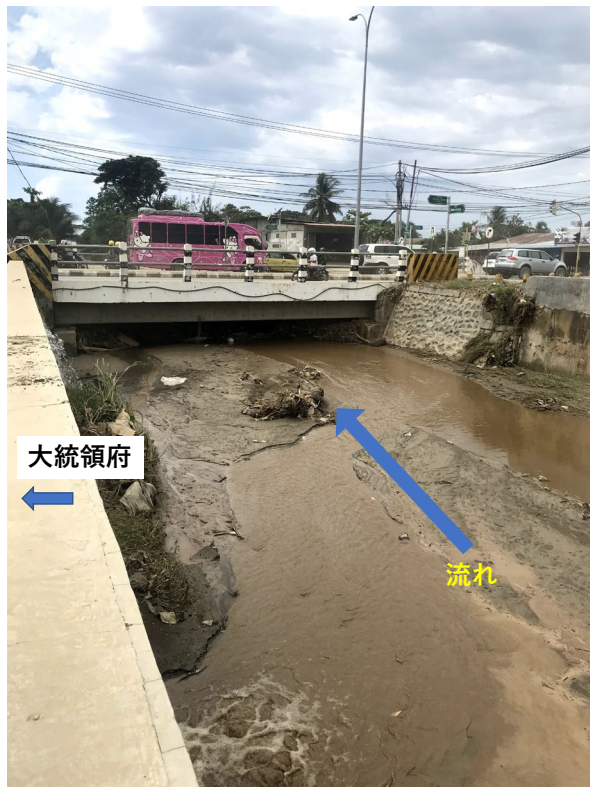
写真1 氾濫域 A の A-point (4月8日撮影)
