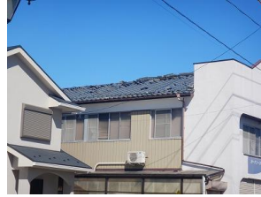
写真 51 瓦屋根の被害
