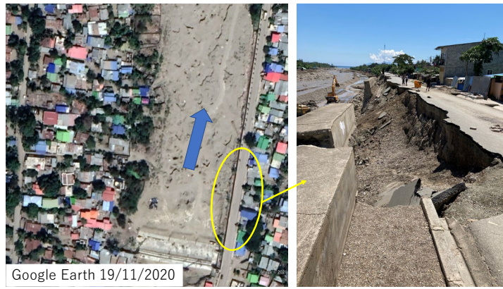
写真8 A-pointの被災状況（Comoro川）（4月12日撮影）
