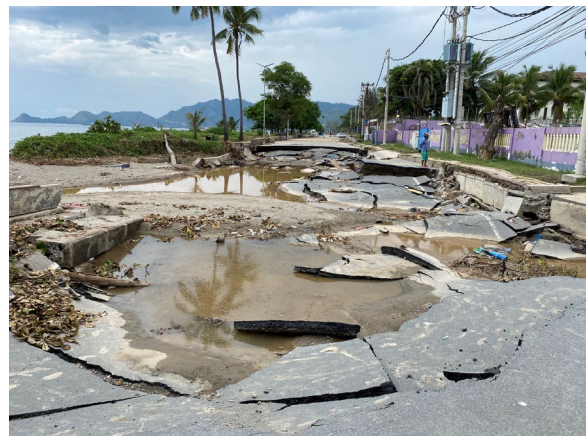
写真5 日本大使館前の道路陥没 (4月8日撮影)
