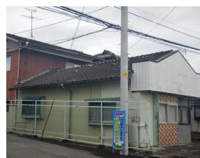
写真 43 瓦屋根の被害
