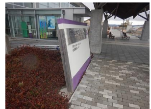
写真12 掲示板の 被害
