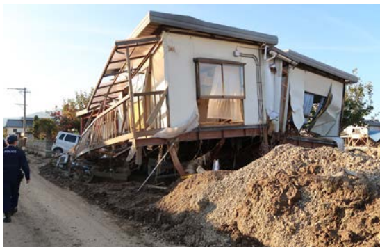
写真1 千曲川の氾濫流による家屋倒壊
