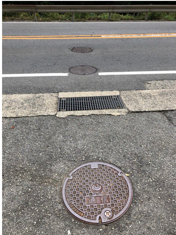
図4. 老ノ坂スノーステーション付近の国道9号沿いの通信ハンドホールの蓋。光ファイバーケーブルはこの下を通っている。
