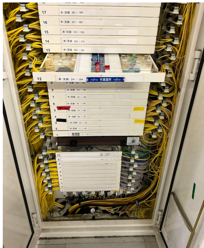
図 2. 光成端架への接続風景。利用したケーブル #253 が収納されている引き出しを出した状態で撮影。
