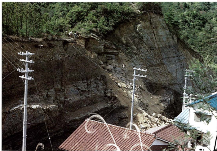
羽衣台の崩壊地（昭和48年4月）
