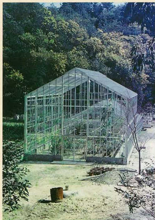
温室の建設（昭和44年7月） 海外からの見本樹の導入が急激に増加した
