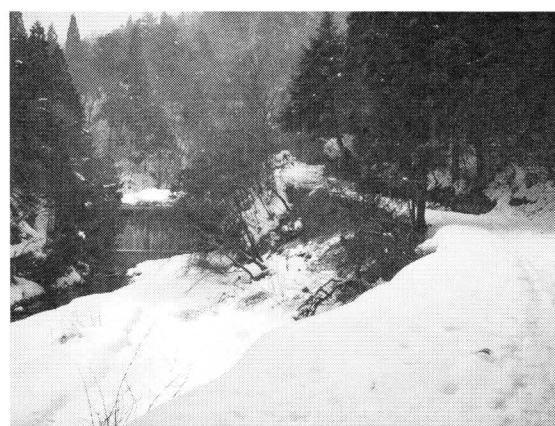
内杉林道擁壁崩壊
