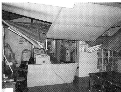
事務所天井落下
