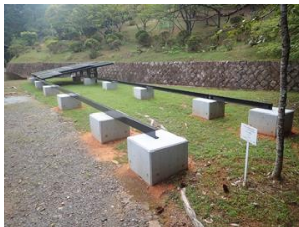
太陽光発電増設用基礎とパネルフレーム
