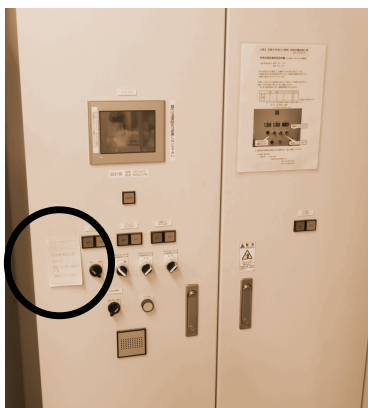
写真3 空調機の制御盤と貼り紙（丸囲部）
