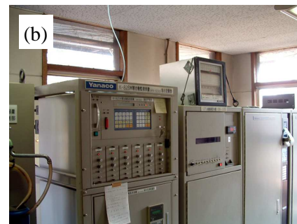
図 1 排水水質自動監視システム (Anatec Yanaco)
