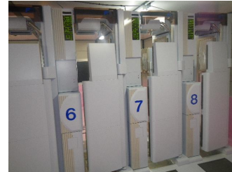
ゲートモニタ(非管理区域側より)
