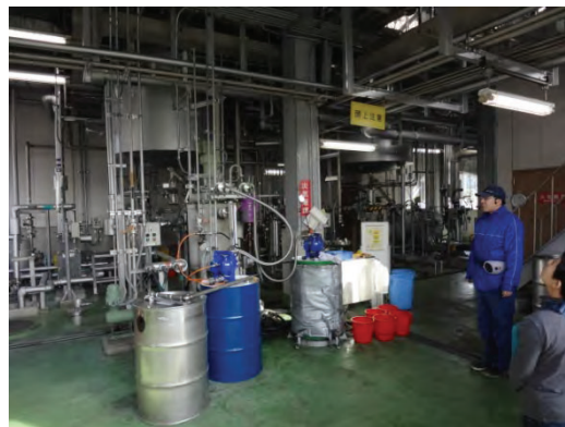
廃食用油燃料化施設（2）
