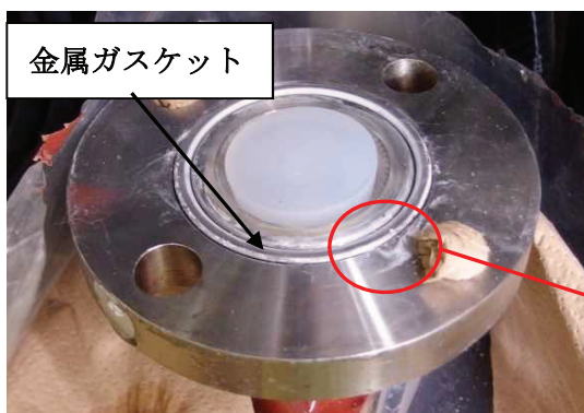
写真3 漏洩箇所のステンレス製フランジ
