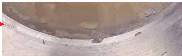
写真6 腐食部の拡大
