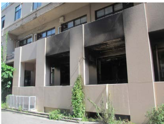
実際の火災現場
