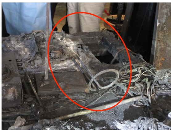
火元と推定された 投げ込み式ヒーター
