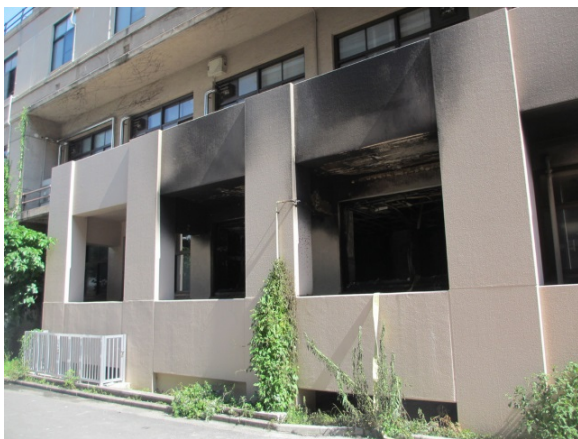
実際の火災現場
