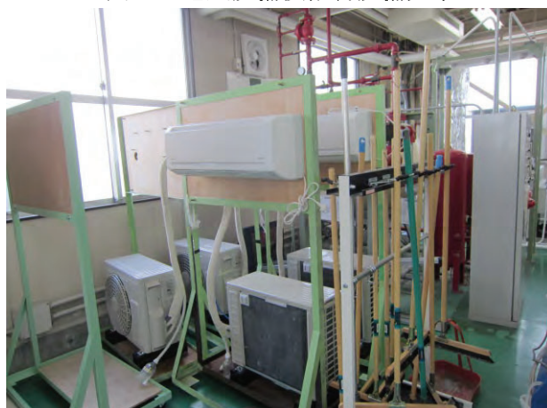
図 9 ビル設備サービス科設備見学
