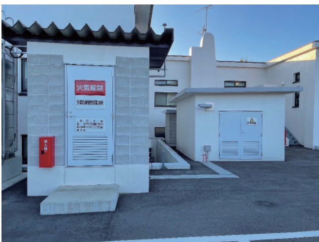
本館敷地内に設置されている自家発電設備
