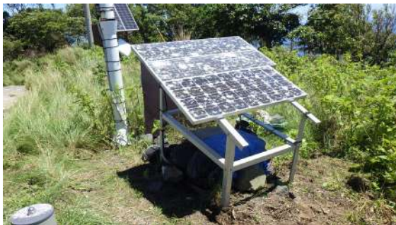
図5 2015年6月19日の噴火により被災した観測点。火山礫によりソーラーパネルのほぼ全面が割れている状況。
