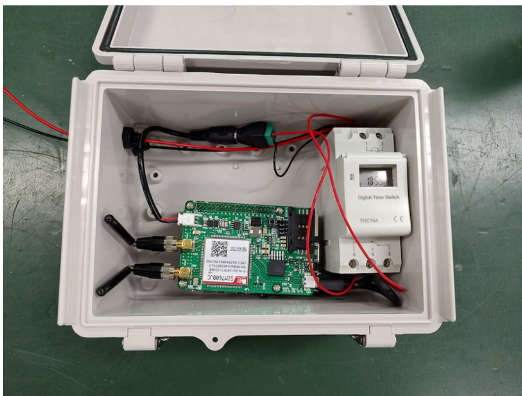
写真 2. 観測用ボックス収納状況
