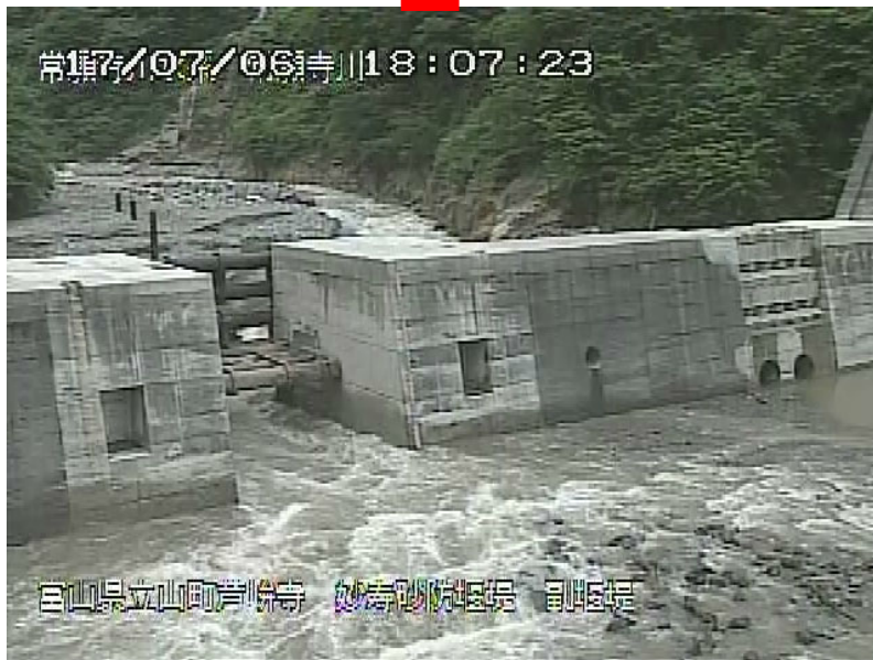
出水後：捕捉土砂の流出
