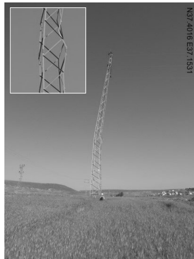
写真-13 断層と送電線の交差により鉄塔に生じた部材座屈
