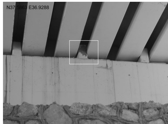
写真-10 横ずれ防止ブロックの損傷
