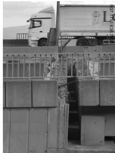
写真-9 橋台とデッキのジョイント部の損傷
