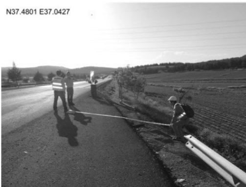
写真-12 断層変位に伴う道路の横ずれ
