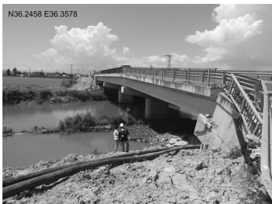
写真-11 傾斜した橋台
