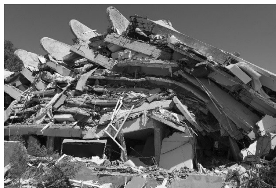
写真-2 パンケーキ状に破壊した建物 (Antakya)
