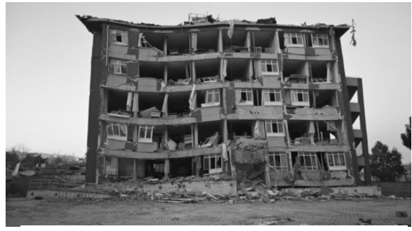
写真-13 倒壊寸前の5階建てRC造建物
