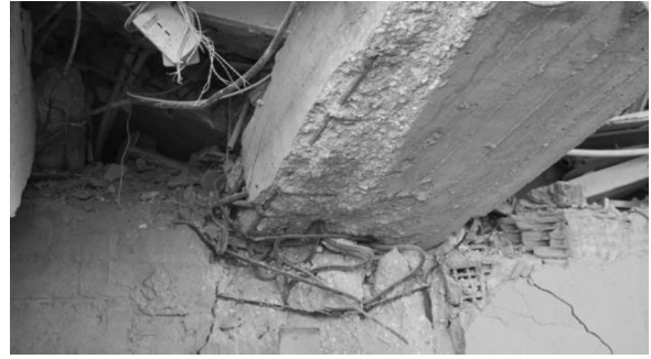
写真-15 倒壊建物の柱・梁の接合部
