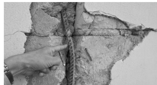
写真-11 校舎北西隅柱周辺の鉄筋の座屈
