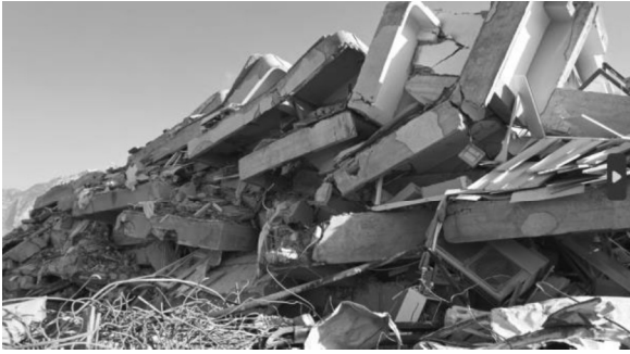
写真-14 パンケーキ状倒壊した7階建てRC造住宅
