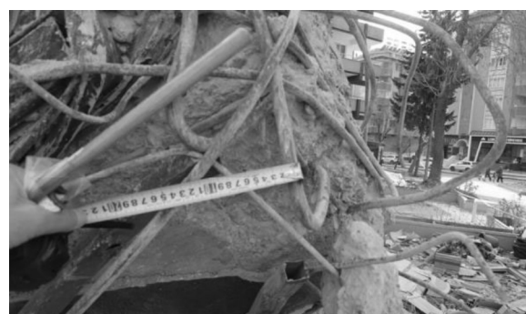
写真-4 1階柱の破壊断面
