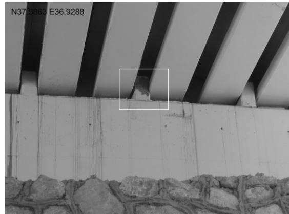
写真-10 横ずれ防止ブロックの損傷
