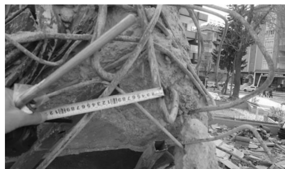
写真-4 1階柱の破壊断面
