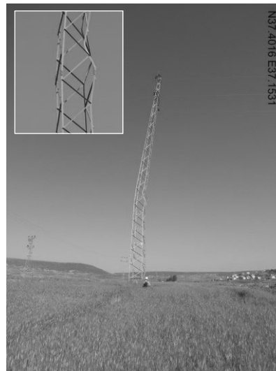
写真-13 断層と送電線の交差により鉄塔に生じた部材座屈
