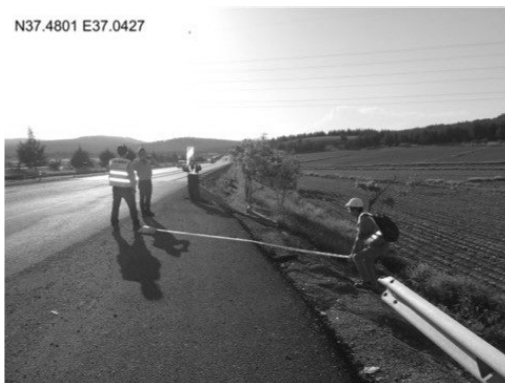
写真-12 断層変位に伴う道路の横ずれ
