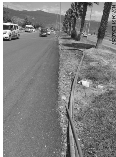
写真-14 断層変位との交差点で座屈し地表に露出した埋設管（用途不明）
