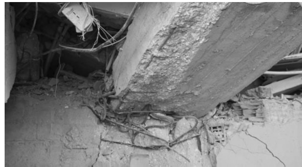
写真-15 倒壊建物の柱・梁の接合部
