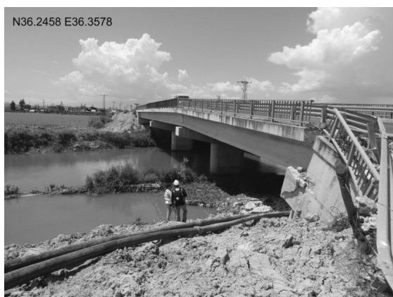
写真-11 傾斜した橋台
