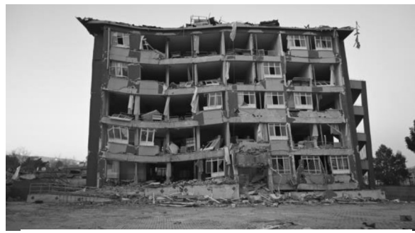
写真-13 倒壊寸前の5階建てRC造建物
