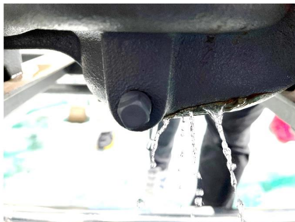
図3. 散水ポンプのケーシングの亀裂から散布水が漏れている様子
