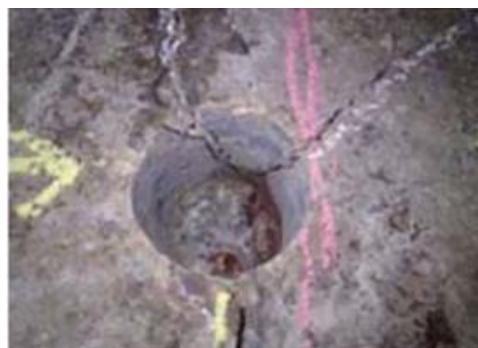
写真 2-2 コア孔から観察されたシースに到達したひび割れ
