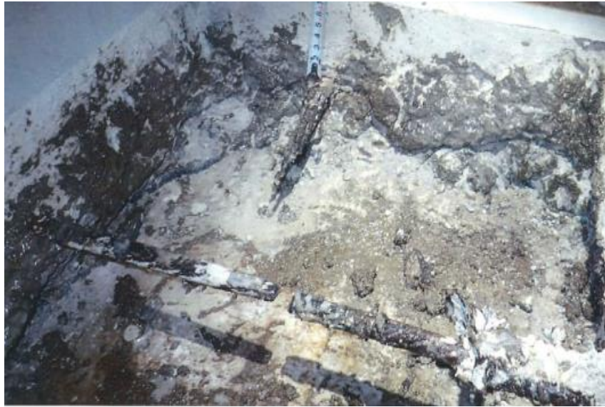
写真 2-4 PC 鋼材の破断の状況
