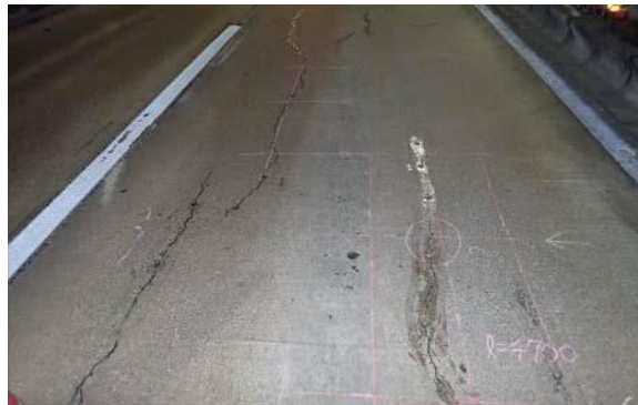
写真 2-1 PC 舗装版のひび割れの状況
