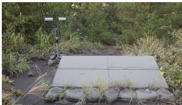
引ノ平川上流降灰観測点ソーラー状況
