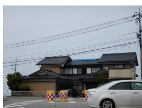
写真6 瓦屋根の被害
