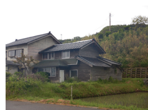
写真 22 瓦屋根の被害
