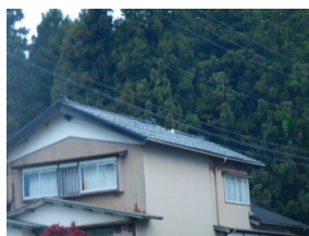
写真 16 瓦屋根の被害
