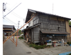
写真11 全壊した木造建物
