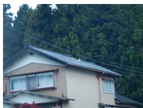
写真 16 瓦屋根の被害
