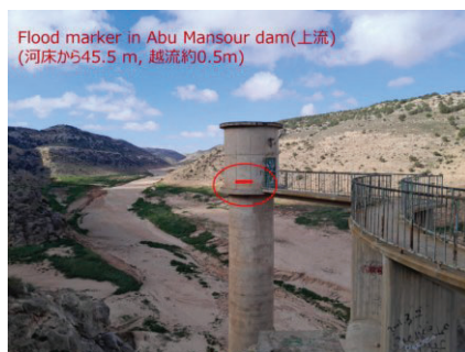
写真1 Abu Mansourダム（決壊後）から上流を望む
