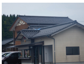
写真27 瓦屋根の被害
