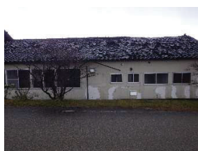
写真3 瓦屋根の被害
