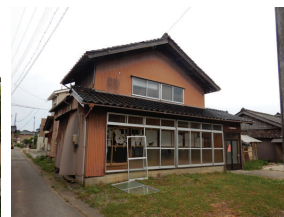
写真12 全壊した木造建物
