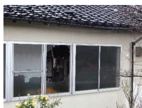
写真4 窓ガラスの被害
