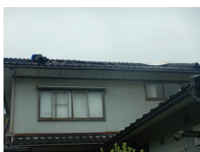
写真28 瓦屋根の被害
