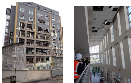
被災した病院の例（トルコ南部）
