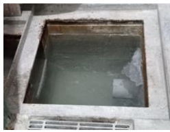
図4 排水柵Bからの排水不能
