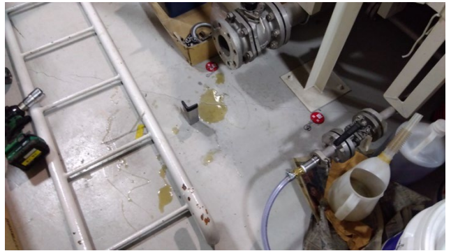
図8 ガスバッグ入口配管からの油漏れ
