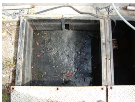
Fig. 5-7 閉塞時の土壌処理槽
