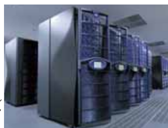
2001（平成13）年に設置されたバイオインフォマティクスセンターのゲノムネットサーバー。
