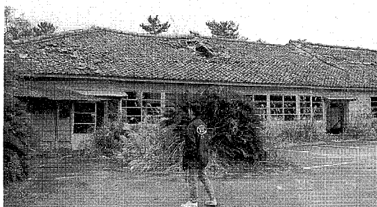
図2 壁内部から屋根組みの木材にまでイエシロアリによる激しい被害を受けた廃屋
