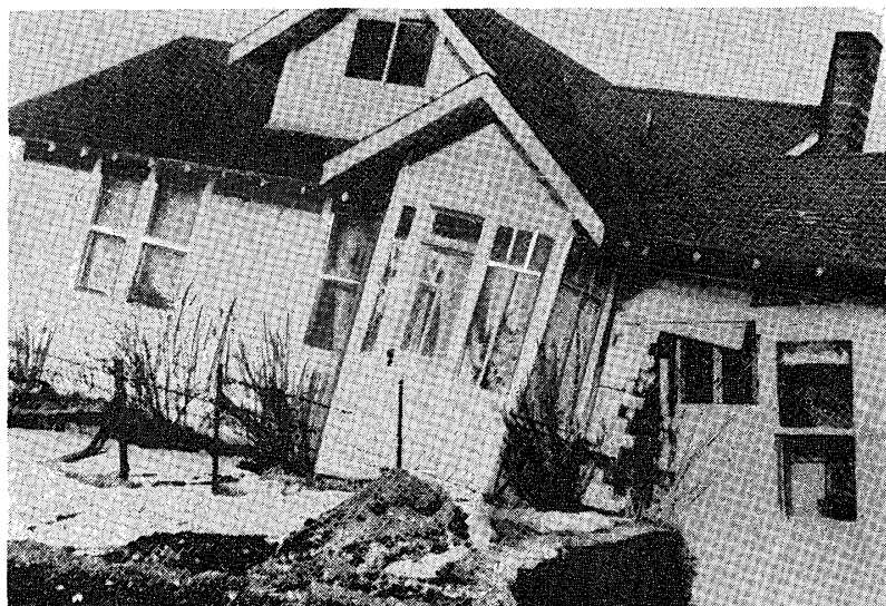
写真1 Sheathing が無いため基礎の不同沈下で上部構造が破損した木造家屋 29) (アラスカ地震)(日本の木造住宅にはこの種の構造が多い)
