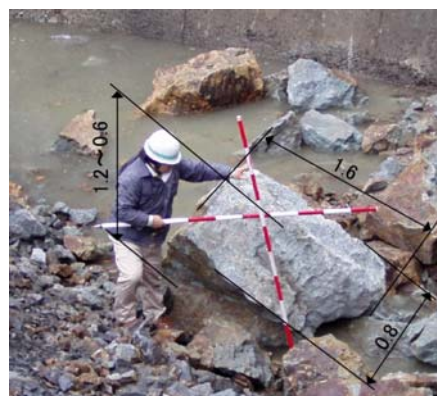
図-4.2.2.2 落下した岩塊の計測
