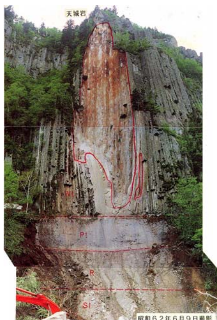
写真-2.1.3 層雲峡(天城岩)(1987) 崩壊高さ 120m, 最大幅 15m, 奥 行き 4~5m 崩落土量(11,200m 3 )
