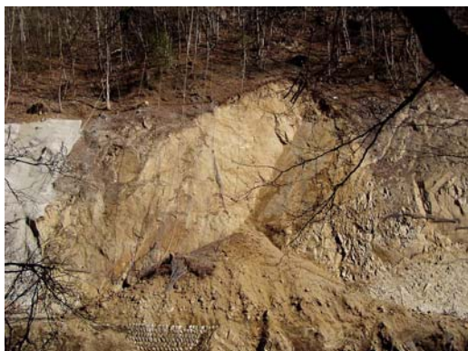
写真-2.1.7 道路改良中工事中の既設斜面の切土で発生. 崩壊高さ 15m, 最大幅 10m, 崩壊土量 250m 3 .
