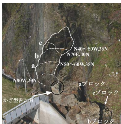
図3.4.5 崩壊地の崩壊直後の状況写真
