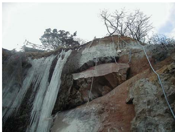
図 2.2.14 凍結融解が原因とみられる切土面での崩壊 (北海道, 恵山町)
