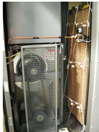
図 3.3 空調機ファンとコイル
