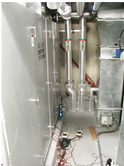
図 3.2 対象とする空調機
