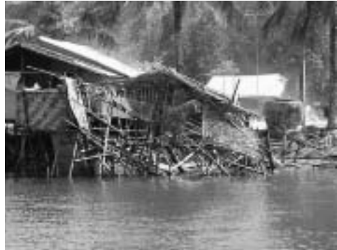
写真3 津波により倒壊した家屋
