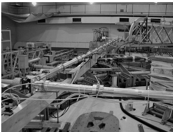
図1. 電子サイクロトロン共鳴加熱・電流駆動システム
