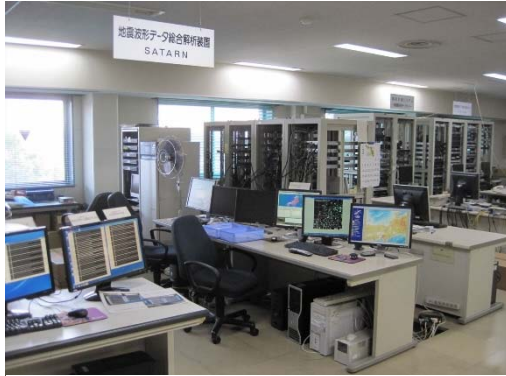
Figure 4 サーバルーム
