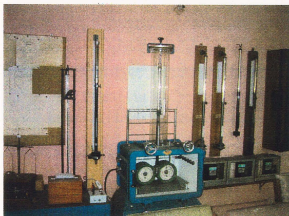
図 2: DHM 本局測器検定室
