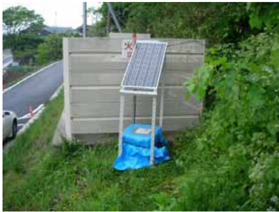
a. Solar panel (GT136)
